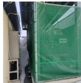
導入した非常用自家発電機
